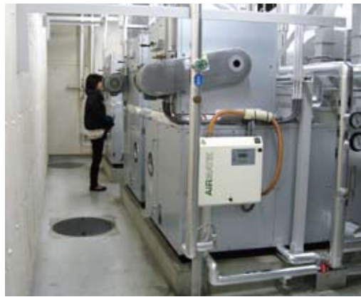
1階 機械室収蔵庫系統新しい空調機
